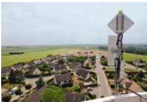
Exemple d'une BLR installée en haut du château d'eau de Donnemain (canton de Châteaudun).
